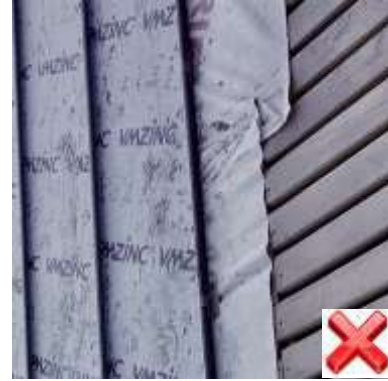
Örtü, havalandırma kesitini engelliyor.
